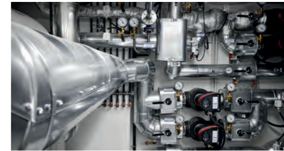
Die Heizungszentrale: gute Revisionierbarkeit trotz hoher Installationsdichte.
