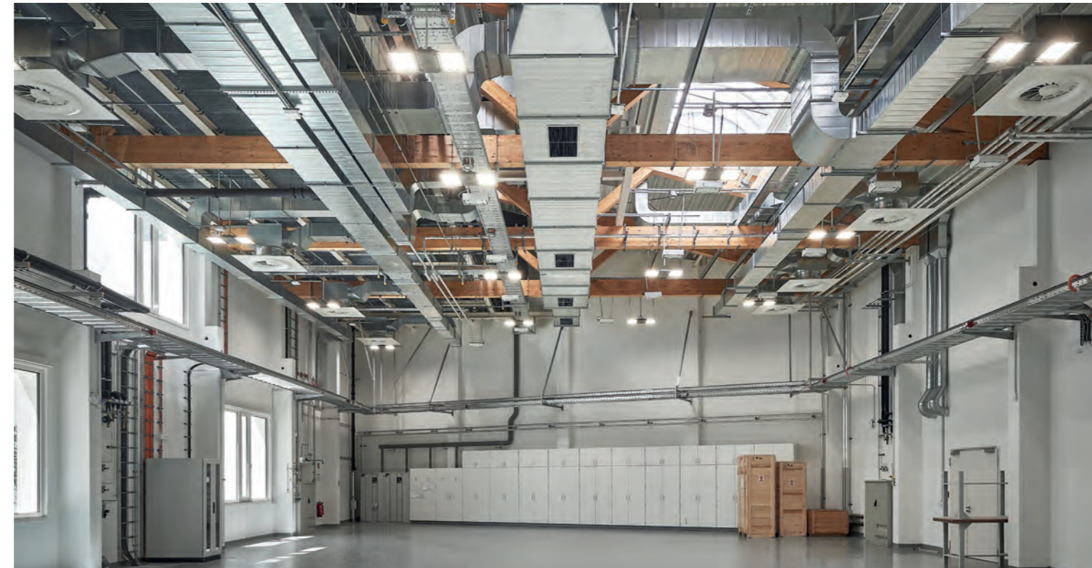
Modernste Forschungsinfrastruktur für die Forschungsarbeit der Projektgruppe IWKS, angefangen bei chemischen Laboren bis hin zu Technikumshallen, in denen neu entwickelte Recyclingtechnologien aufgebaut und getestet werden können.
