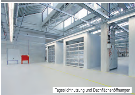
Be- und Entlüftung der Halle
