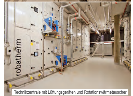
Technikzentrale mit Lüftungsgeräten und Rotationswärmetauscher
